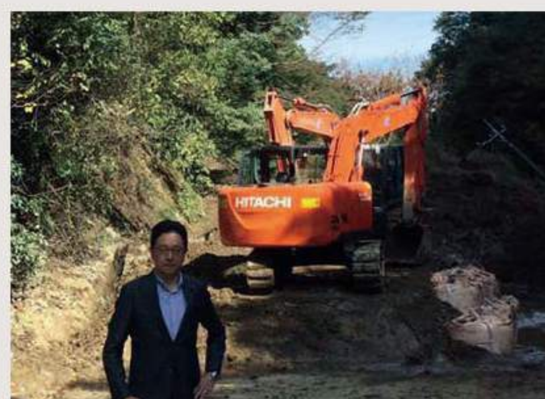
がけ崩れで埋まった道路を視察（2017年10月）
